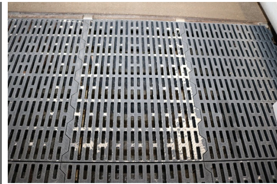
Traditionel plastspaltegulv med rester af skridsikker maling
