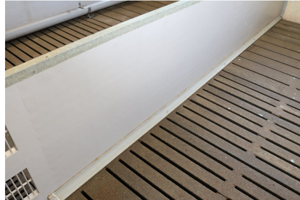
Billede 2. Sti med betonsplategulv og drænet gulv behandlet med NanoCover Gulvforsegling, Ikadan-inventar med hulkelslister og uden stolper og fodplader
